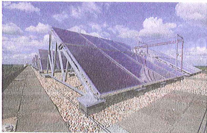
Warm water komt van het dak waar zonnepanelen staan opgesteld.
