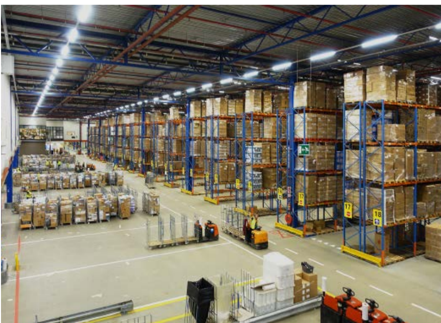
De immense magazijnen van Action in Zwaagdijk-Oost zijn volledig uitgerust met een sprinklersysteem dat nu ook van Zonecheck gebruik maakt.
